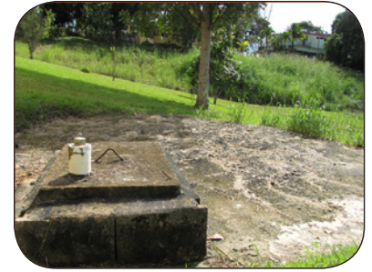
Mantenga el pozo séptico sellado.
